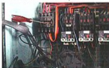
Installation électrique défectueuse
