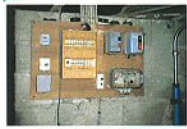
Installation électrique correcte
